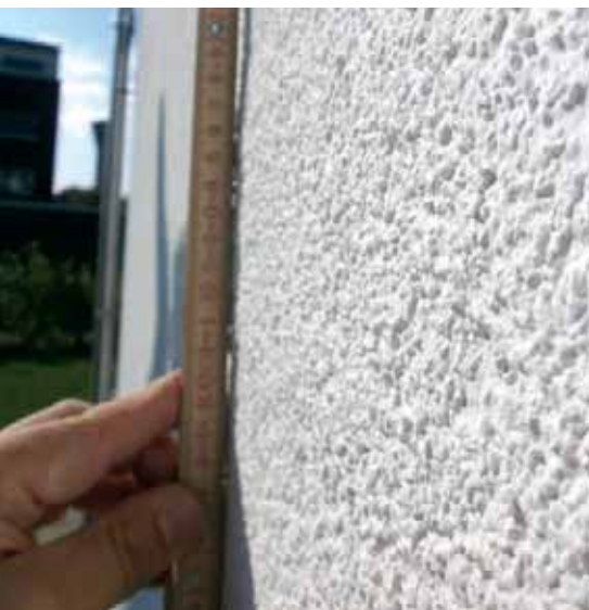
Photo 3: exemple de décollement de crépi de façade
