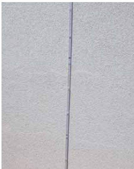
Photo 2: les décollements en forme d'onde ne se voient pas qu'en lumière rasante.
