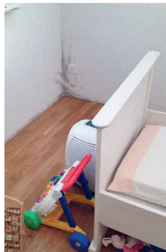
Photo 10: maison 2, appartement au rez-de-chaussée avec moisissure.
