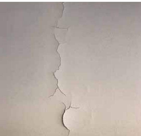
Sur ce mur, les colonnes montantes ont été recouvertes avec un matériau différent du reste de la surface.
