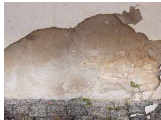
Efflorescenze saline su una superficie.
