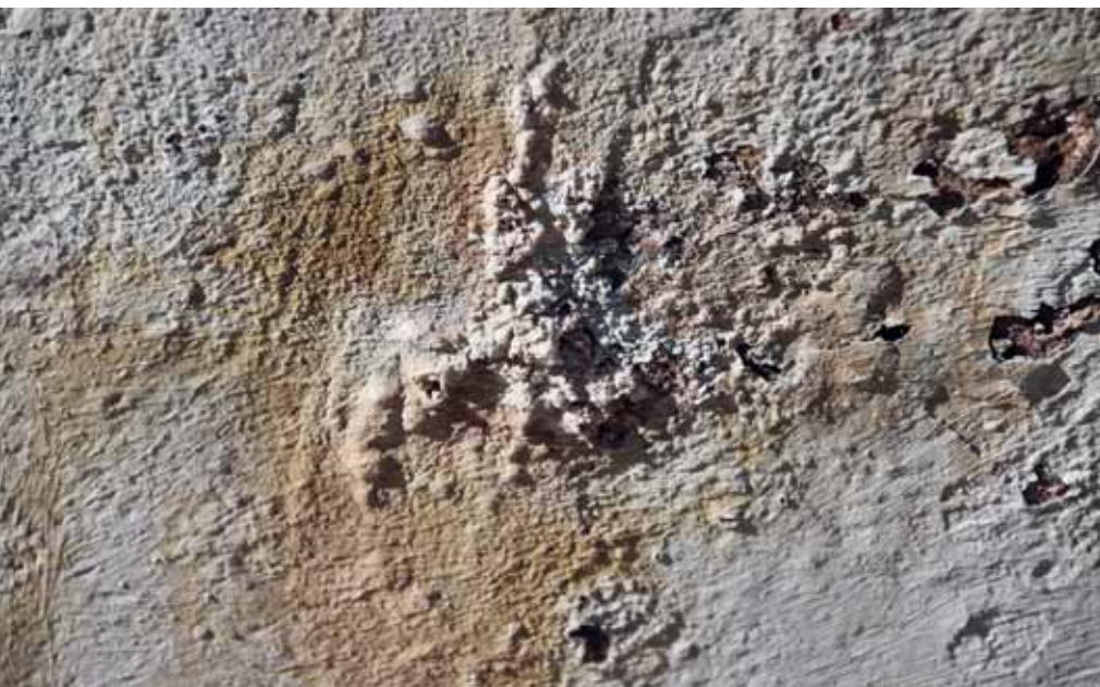
Risalita di umidità e sale in un'opera di muratura.
