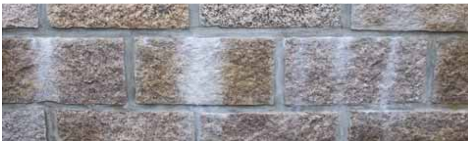
Scheggiaura, efflorescenze e gravi danni da sale a una struttura in muratura.
