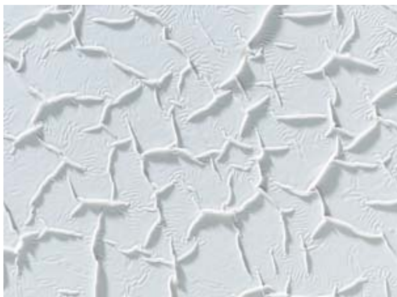
Ungenügende Trocknung des Voranstriches oder eine zu hohe Schichtdicke ist in der Regel die Ursache für eine solche Runzelbildung.
