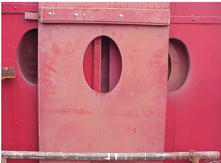
Während Jahren der Witterung ausgesetzt, kann die Oberfläche von Fensterläden kreiden, doch die Substanz ist noch gut.
