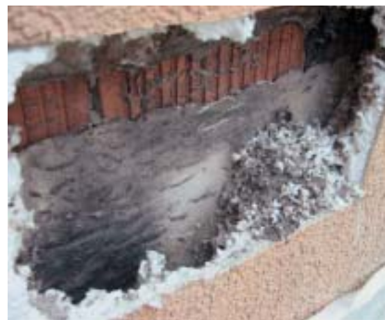
Danni in seguito a collegamento non ermetico con il terreno: materiale isolante distrutto dalle formiche.
