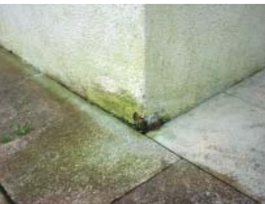
Sfaldamento in seguito a un'insufficiente definizione dei dettagli (impermeabilizzazione).
