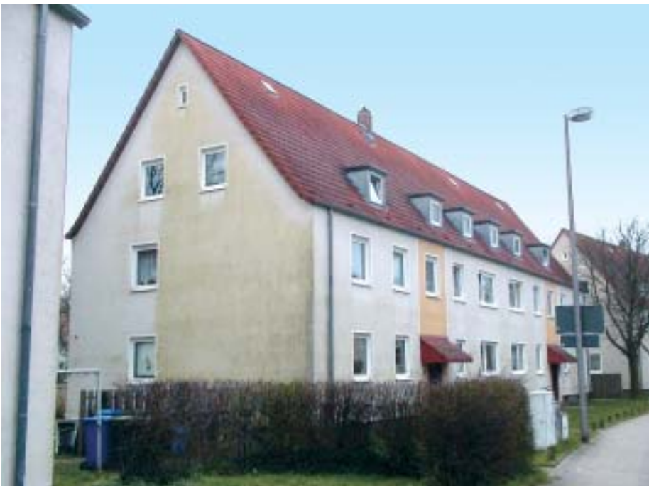
Für die Lebensdauer einer Fassadenbeschichtung ist der Feuchtehaushalt massgebend. Hier eine wärmedämmte Fassade mit Silikonputz, die bereits nach vier Jahren von Algen befallen ist.
