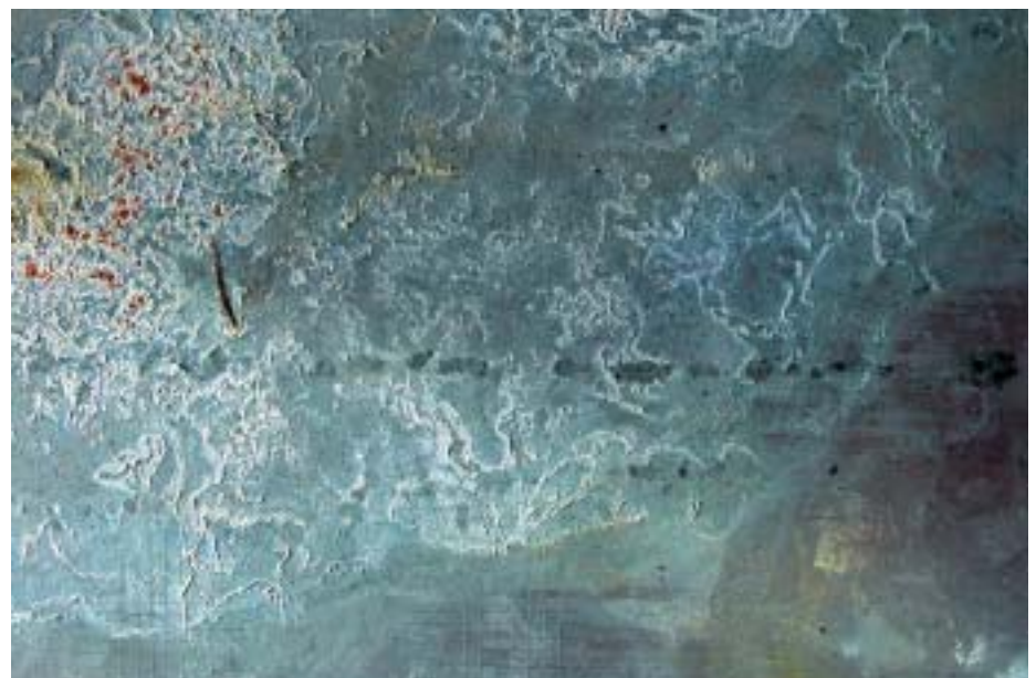
Leichter Weissrost beeinträchtigt die Gebrauchsfähigkeit von Stahl nicht, muss aber entfernt werden, falls ein Anstrich aufgebracht werden soll.
