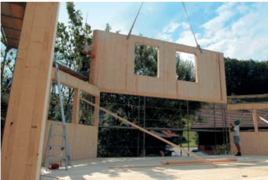
An diesem achteckigen Bau in Mosnang (Toggenburg) wurden vorwiegend Baumaterialien aus nachwachsenden Rohstoffen verwendet.
