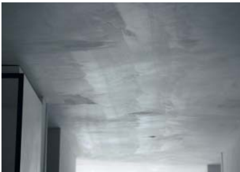
Eine Sinterschicht muss auf jeden Fall mechanisch entfernt werden.
