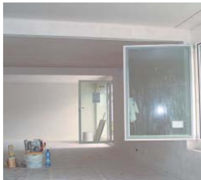
Durch gezieltes Lüften wird der Feuchtigkeitswert des Weissputzes gesenkt. Erst wenn die Restfeuchte unter 1% liegt, ist die Oberfläche bereit für einen Anstrich.
