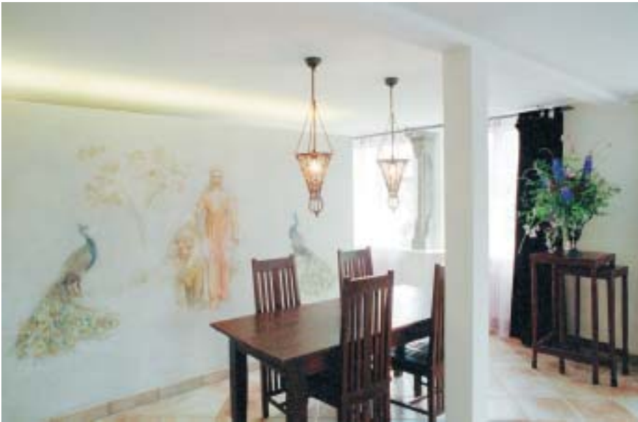
Streiflicht lässt allfällige Fehler in Weissputzoberflächen besonders stark hervortreten.
