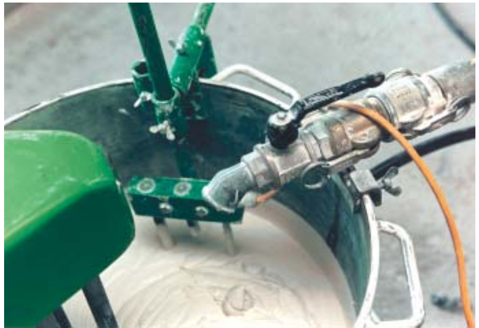
Der Materialtransport erfolgt von einer zentralen Stelle aus an den gewünschten Ort. Eine Füllstandsonde regelt den Materialfluss.
