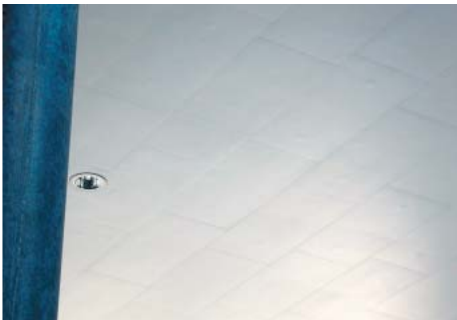
4 Abzeichnungen der Plattenstösse der Wärmedämmplatten sind auch an Untersichten möglich, obwohl keine direkte Besonnung vorliegt.
