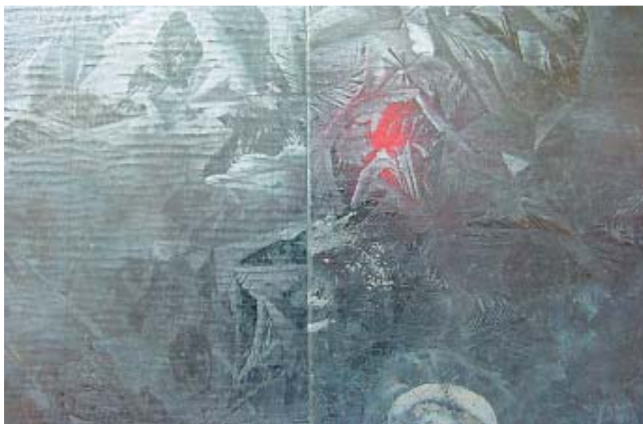
Una lamiera zincata a caldo con fioriture che lasciano intravedere il sottile strato di zinco.
