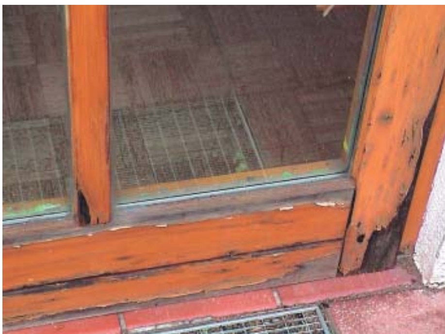
Typisches Schadensbild einer Dickschichtlasur. Der Renovierungsaufwand ist gross.
