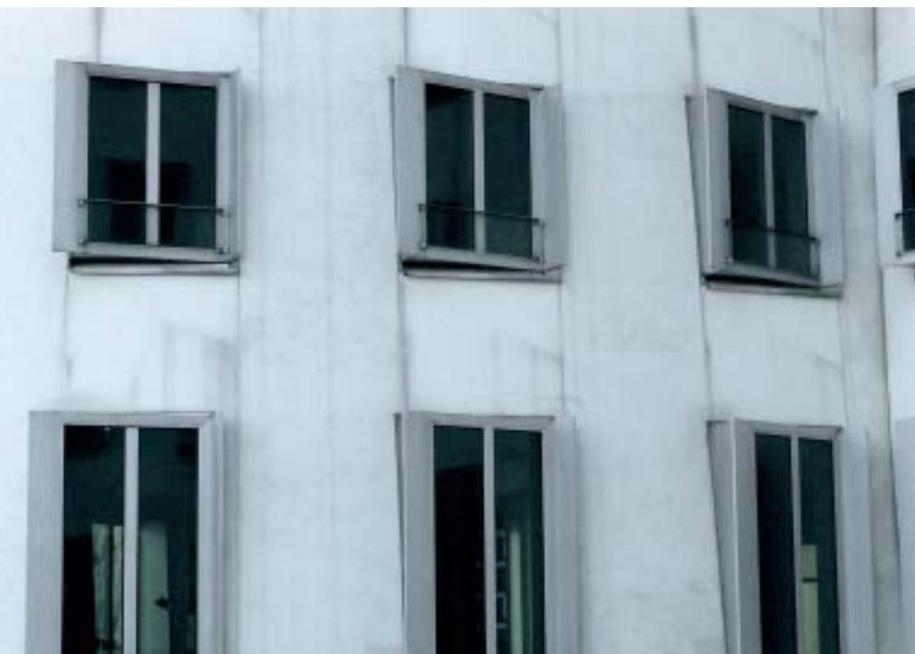
Dieses Beispiel einer extrem hydrophoben Farbe mit Lotuseffekt zeigt nach zwei Jahren Bewitterung die kanalisiert Abläufer aufgrund des «schmutzabweisenden Abperleffekts».
