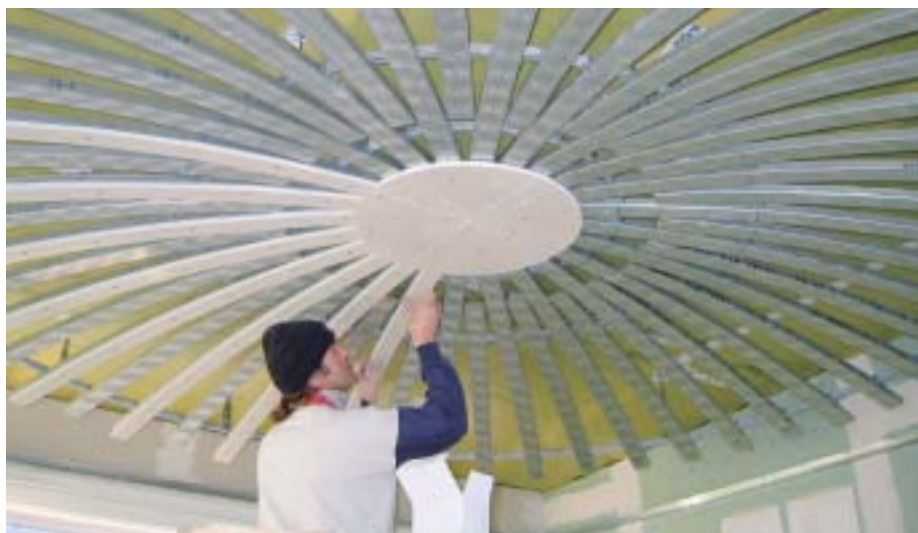
Die Vorfertigung von Einzelteilen im Werk spart auf der Baustelle Zeit und Geld. Hier wird eine vorgefertigte Kuppel aus Einzelteilen zusammengesetzt.
