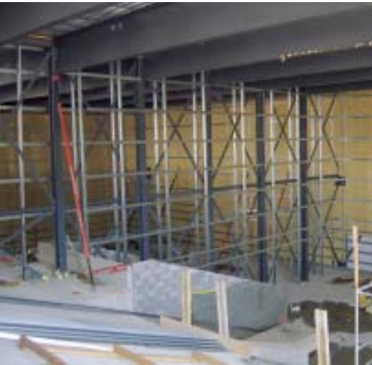
Im Kino Europlex in Lausanne wurden in sieben Kinosälen in Trockenbauweise Wände in einer Höhe bis zu 11 m erstellt.
