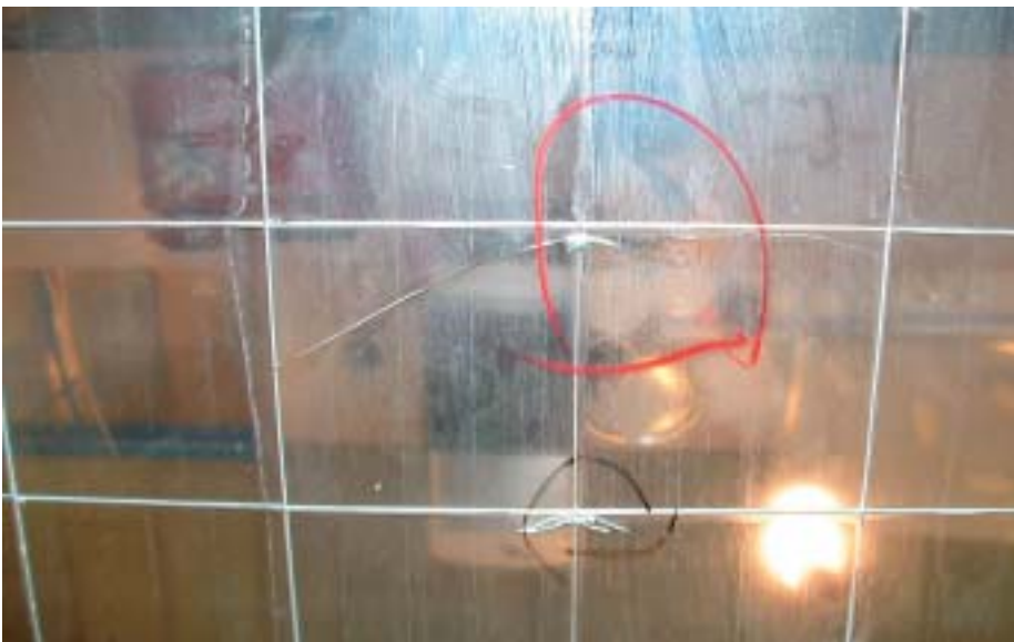
Diese Spiegelkacheln wurden auf Gipskartonplatten geklebt. Deren Schrumpfen beim Trocknen erzeugte Druckspannungen, die an den Spiegelflächen zu Absplitterungen führten. (Die Spiegelfläche ist mit Schutzfolie überklebt, um die Glassplitter aufzufangen.)
