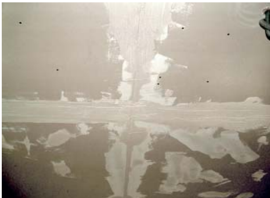
Nicht fachmännisch ausgeführte Spachtelung.
