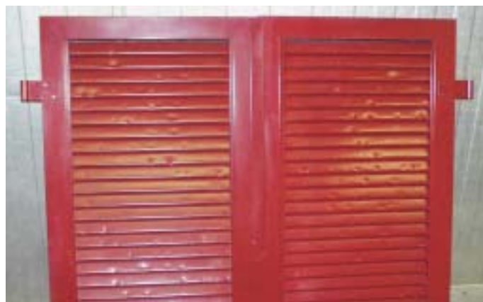
Hagelschäden lassen sich bei Aluläden nicht reparieren, während Holzläden einfach gespachtelt werden können.
