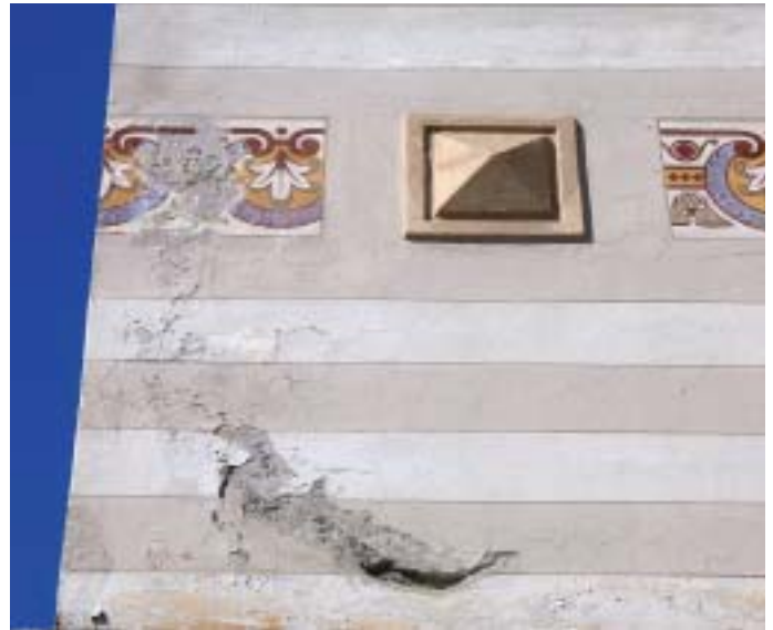
Schäden am Nordrisalit. Hier musste der Putz grossflächig erneuert werden.
