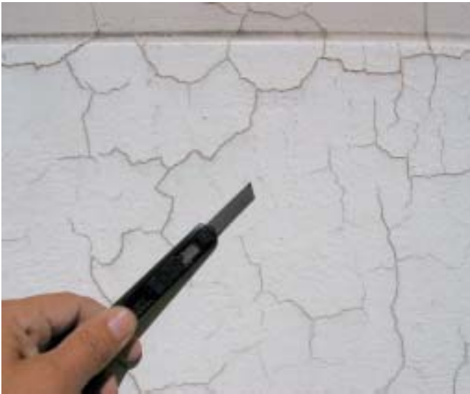
Der Renovationsanstrich von 1965 wurde mit Dispersions-Fassadenfarben durchgeführt und zeigte sich vor der Renovation von 2004–2006 extrem versprödet.
