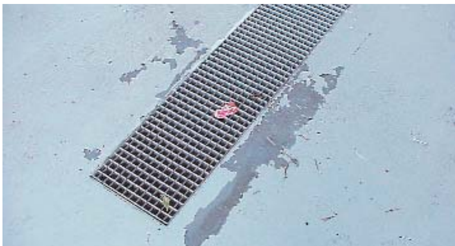
Verschmutzte Böden, z. B. durch Ölkontamination, vermindern die Haftung von Anstrichen und führen häufig zu Anstrichablösungen.
