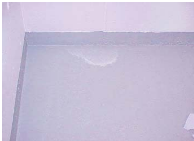
Eine ungenügende Luftzufuhr führt nach dem Aufbringen wasser- verdünnter Bodenversiegelungen häufig zu Kondensatbildung.
