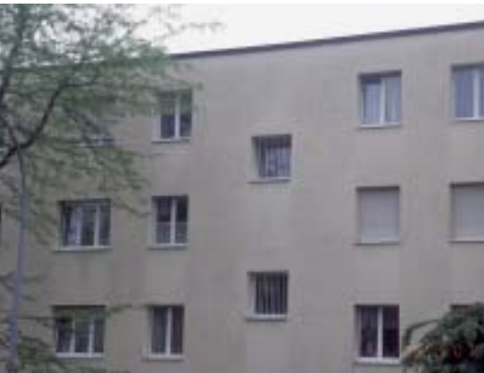
1 Fleckige Fassade: Die Fachleute von QC-Expert fanden heraus, dass der Schaden durch Schimmelpilzbefall verursacht wurde.
