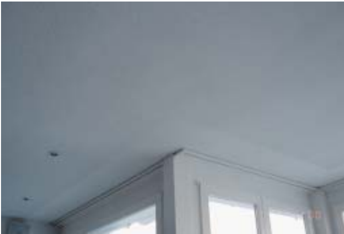
4 Die in der Decke über den Fenstern eingelegten Wärmedämmstreifen zeichneten sich durch Verfärbungen ab.
