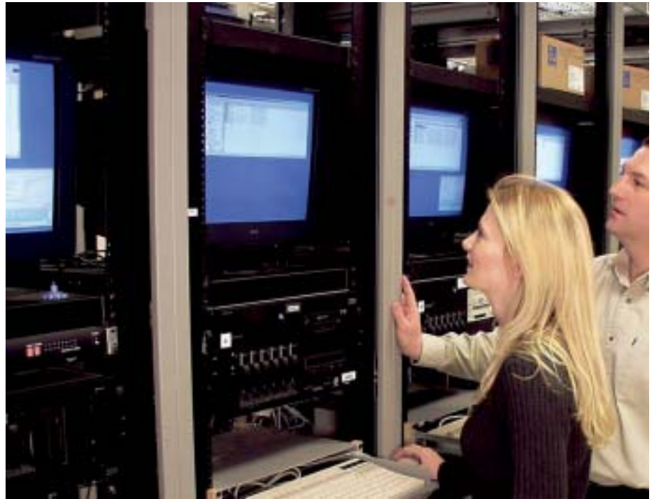
Die IT-Infrastruktur bei einem ASP-Dienstleister ist redundant ausgelegt, also mehrfach vorhanden. Damit wird eine hohe Verfügbarkeit erreicht.
