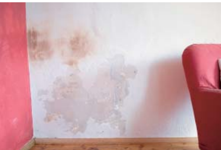
Abgeplatzte Farbe, Ausblühungen und Schimmel: Wasserschäden sind hässlich und können die Gesundheit gefährden.
