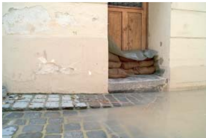
Wenn Flüsse über die Ufer treten, sind Gebäudeschäden vorprogrammiert. Vor der Sanierung kommt es auf eine sorgfältige Schadensanalyse an.
