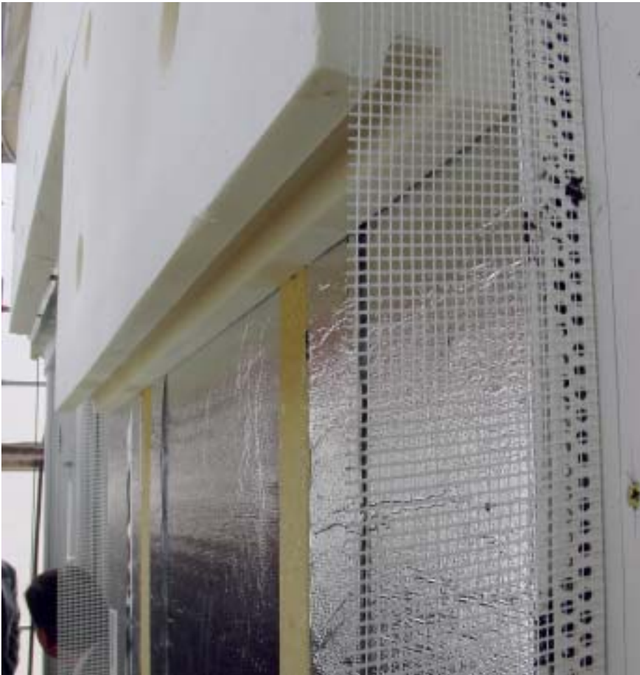
6 Eine zusätzliche Polyurethan-Dämmung schützt die Vakuum-Isolations-Paneele gegen Beschädigung (Konstruktion: energie-tib/Hasit). (Foto: ausbau + fassade, Andreas Gabriel)
