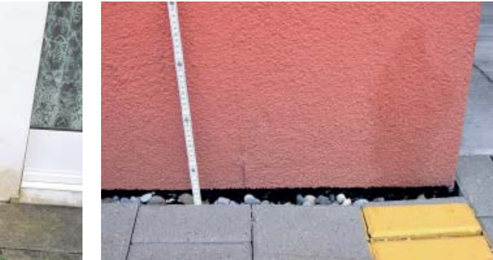
7 Oberhalb der Schwarzbeschichtung ist ein vertikaler Riss zu erkennen. Ursache ist das Schwinden einer zu hoch über die Sockellinie geführten XPS-Platte.
