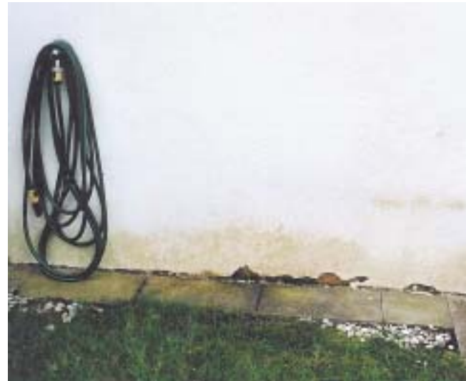
6 Algenbewuchs im Spritzwasserbereich. Der Bewuchs auf den Zementplatten weist darauf hin, dass der Sockel nur wenig besonnt ist und die Deckbeschichtung lange feucht bleibt.
