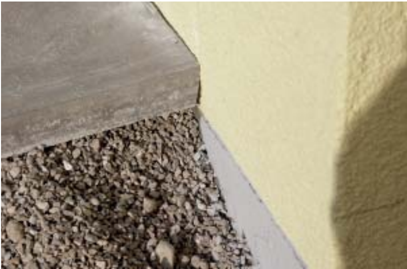
5 Eine Zementplatte drückt gegen die verputzte Aussenwärmedämmung. Zwischen der Platte und dem Aussenputz muss ein Abstand von mindestens 2 cm eingehalten werden. Die Schutzbeschichtung wurde etwas zu wenig hoch ausgeführt.
