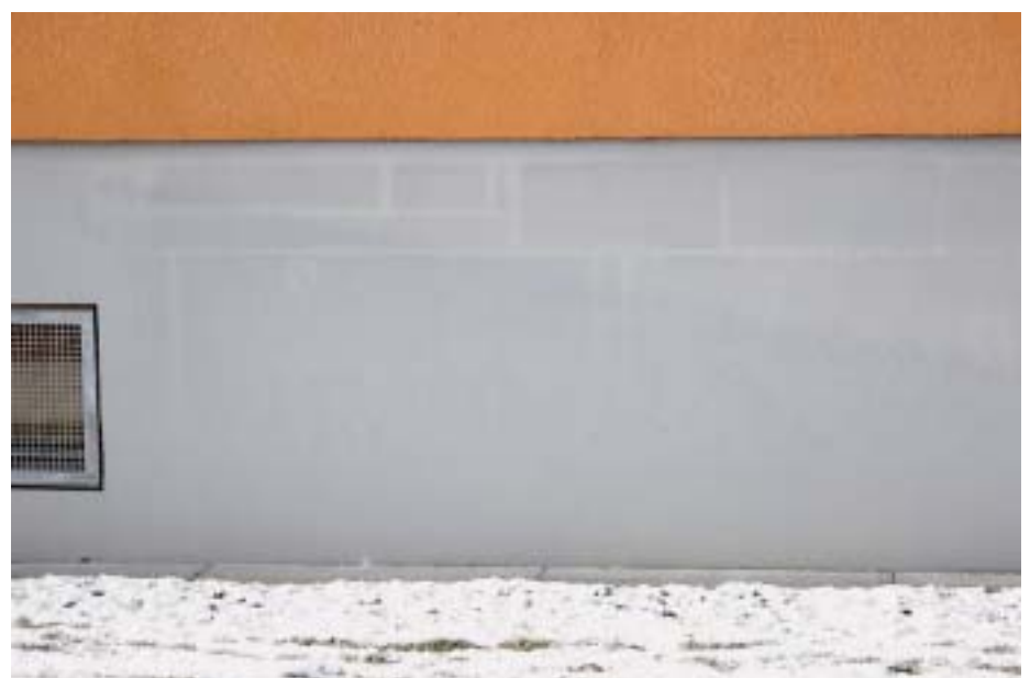
8 Durch das Schwinden der XPS-Platten entstanden Wärmebrücken, die sich auf dem Putz abzeichnen.
