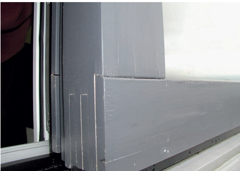
1 Beim Einsatz von Holz geschehen immer wieder Fehler, die zu Schäden führen, wie hier an der Eckverbindung eines Holzfensters.
