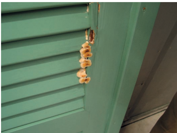
4 Sulla stessa portafinestra, negli angoli non trattati è comparsa un'evidente formazione di funghi.
