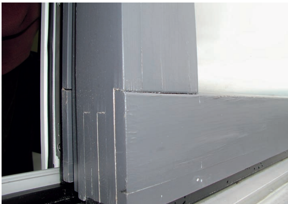
1 Utilizzando il legno si verificano sempre difetti che portano a dei danni, come qui nella giunzione angolare di una finestra in legno.
