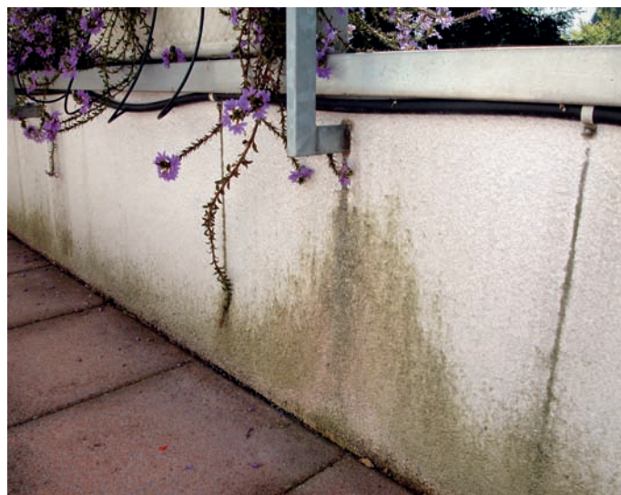
Biogener Bewuchs auf einer verputzten Wärmedämmung einer Terrassenbrüstung.
