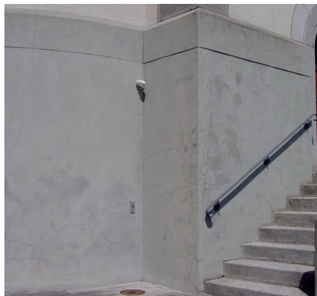
Im Sockelbereich hatte es viele Spannungs- und Netzzrisse im konventionellen, versinterten Putz. (Foto: Alexander Kästli)
