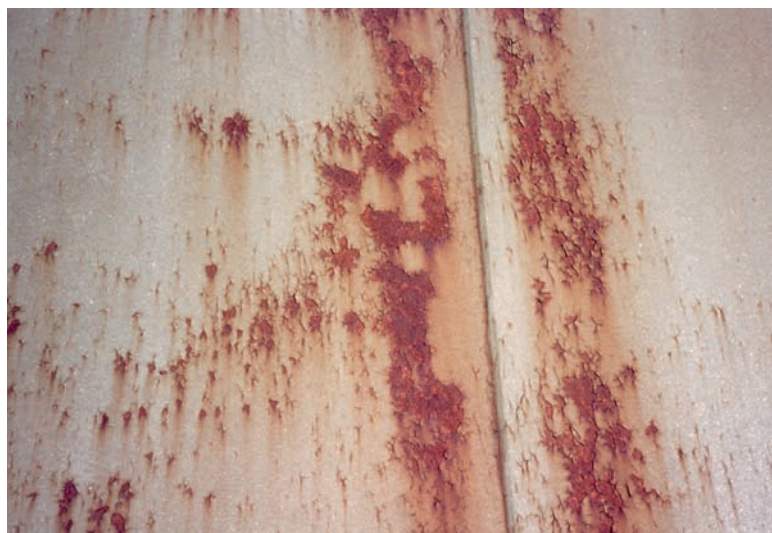
3 Qui il rivestimento è gravemente danneggiato dagli agenti atmosferici e presenta ampie zone spellate. Non svolge quindi più la sua azione protettiva, e deve pertanto essere sostituito.
