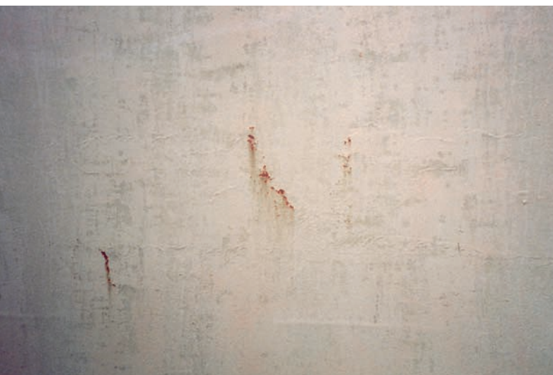
2 Esempio di rivestimento con zone arrugginite isolate e mano finale gravemente danneggiata dagli agenti atmosferici. In questo caso il risanamento richiede l'esecuzione di ritocchi e l'applicazione di una mano finale.
