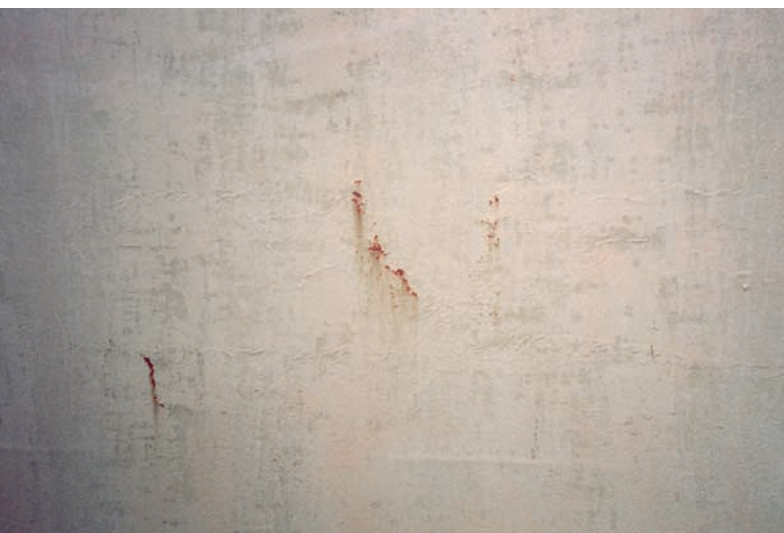
2 Eine Beschichtung mit vereinzelt Roststellen und stark abgewitterter Deckbeschichtung. Hier wird mit Ausflecken und einem Deckanstrich saniert.
