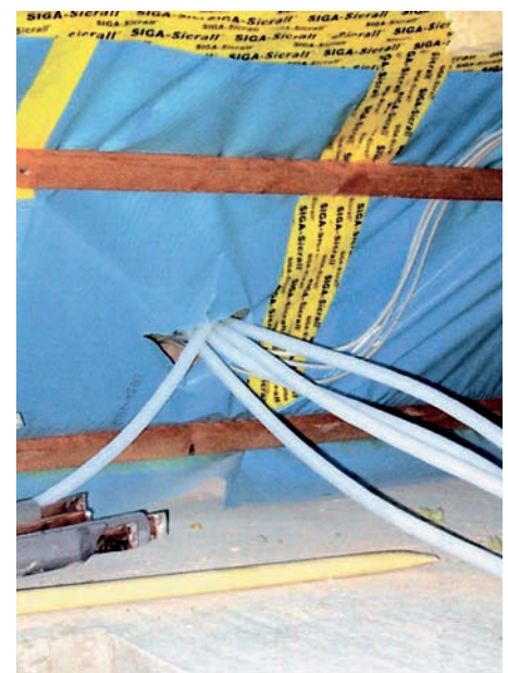
5 Die Elektroinstallation zerstörte hier nachträglich die Dampfbremse/Luftdichteitsebene.
