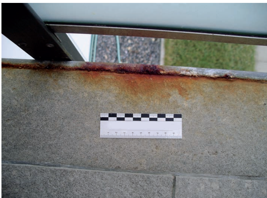
Corrosione di un telaio in acciaio zincato e rivestito adiacente al rivestimento in piastrelle nella parte terminale del parapetto di un balcone.
