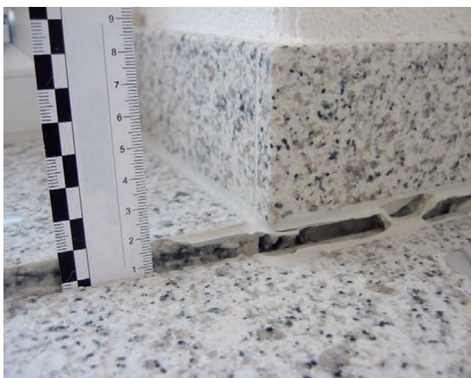
Evidente cedimento del bordo di un rivestimento a pavimento a causa dell'infiltrazione di umidità nell'isolante anticalpestio.
