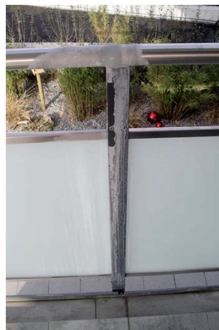
Depositi di calcare su una ringhiera in acciaio al cromo a causa dell' «acqua con calccestruzzo» che, attraverso delle fessure, sgocciola dal balcone del piano superiore.
