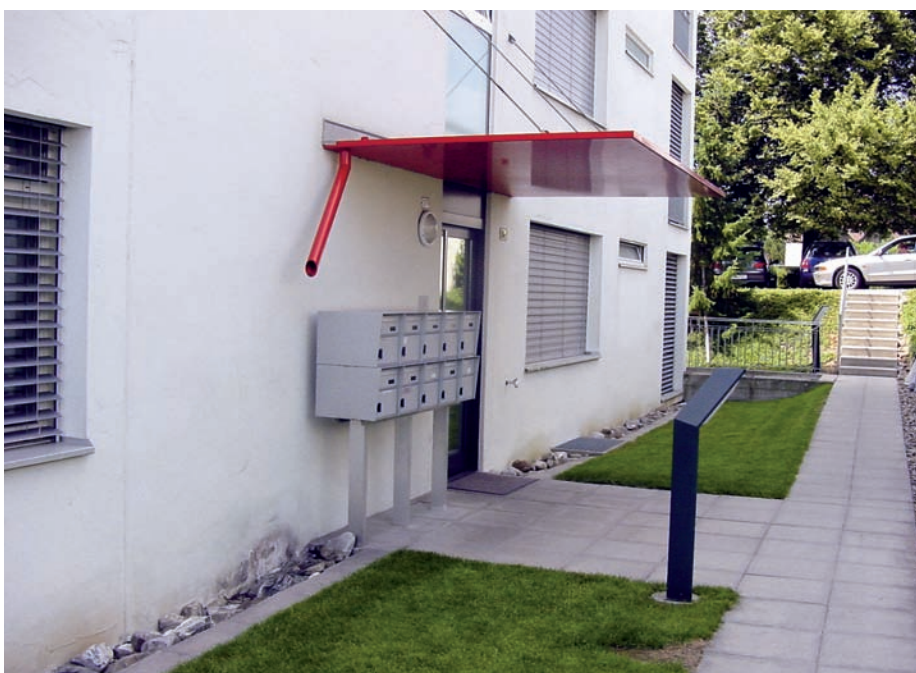
L'acqua piovana che scende dalla tettoia schizza, a contatto con il suolo, sul muro della casa impregnando lo zoccolo dell'isolamento termico esterno intonacato.
