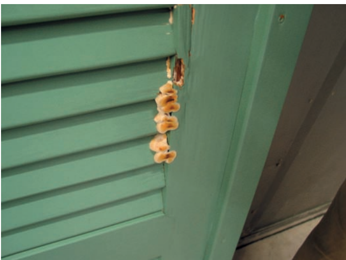
4 La même porte de terrasse a subi une attaque massive de champignons dans les angles non protégés.
