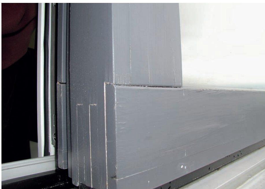
1 L'utilisation du bois est fréquemment à l'origine de défauts qui peuvent entraîner des dommages, comme ici sur l'assemblage angulaire d'une fenêtre en bois.
