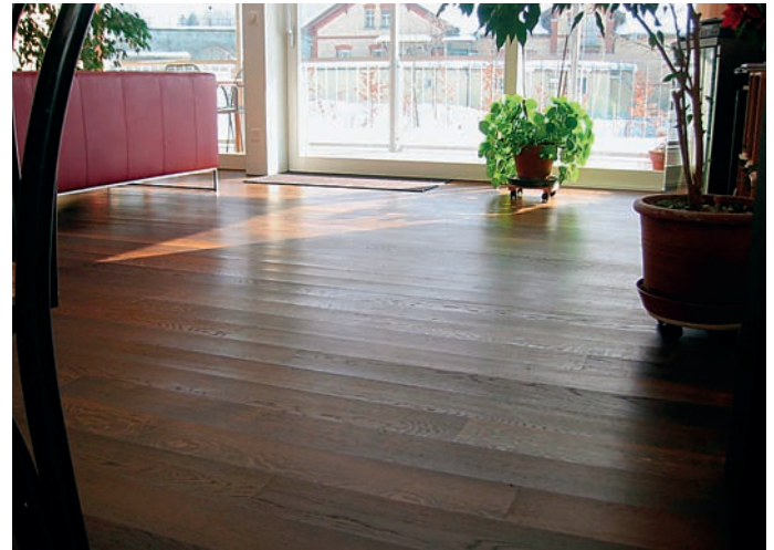
3 Wird ein Bodenbelag auf einem ungenügend ausgetrockneten Estrich verlegt, können teure Bauschäden eintreten wie hier dieses schüsselnde Parkett.
