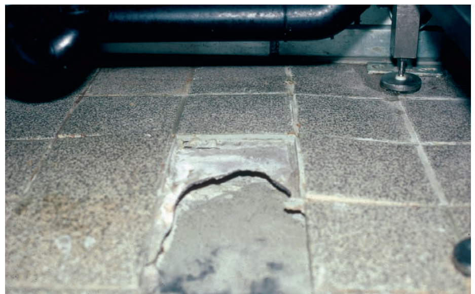
4 Calciumsulfat-Fliesestriche sind ungeeignet für Nassräume. Bei dieser Betriebsküche löste sich der Plattenbelag infolge Durchnässung des Calciumsulfat-Fliesestrichs grossflächig ab.
