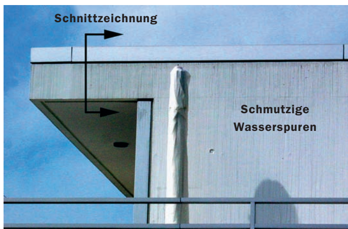
2 Typisches Erscheinungsbild der verschmutzten Fassade. Der Beton war anfänglich weiss.
