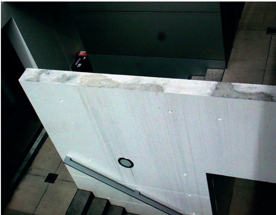
4 Verschmutzungen bei der Betonmauer der Aussentreppe (Abläufer und Pfützen auf der Mauerkrone).
