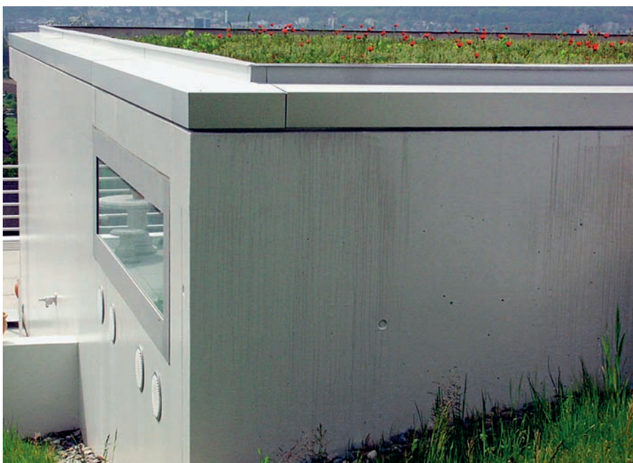
1 Diese Betonfassade wies weniger als ein Jahr nach Bauabschluss hässliche Abläufer auf. Die Gründe lagen in einer falschen Konstruktion des Dachrands und in einem hydrophoben Anstrich.
