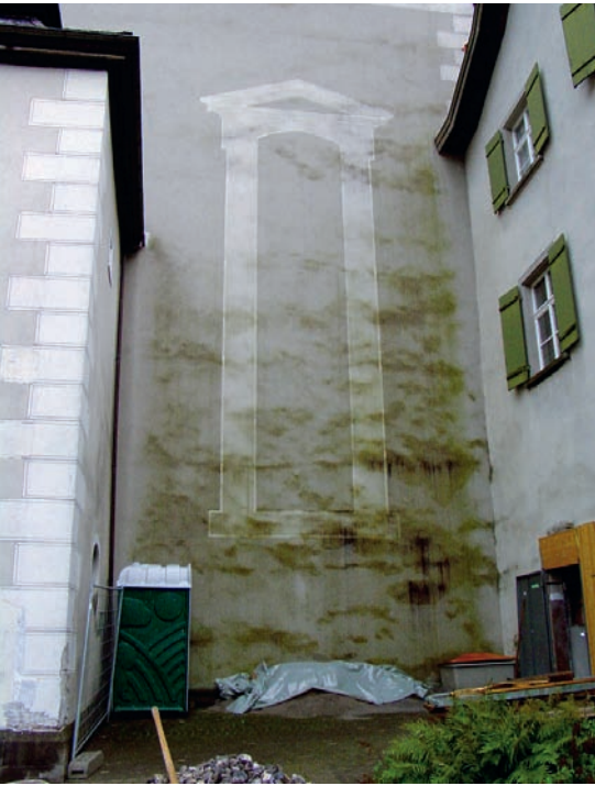
Die Fassade zeigte stellenweise starken Algenbefall.
