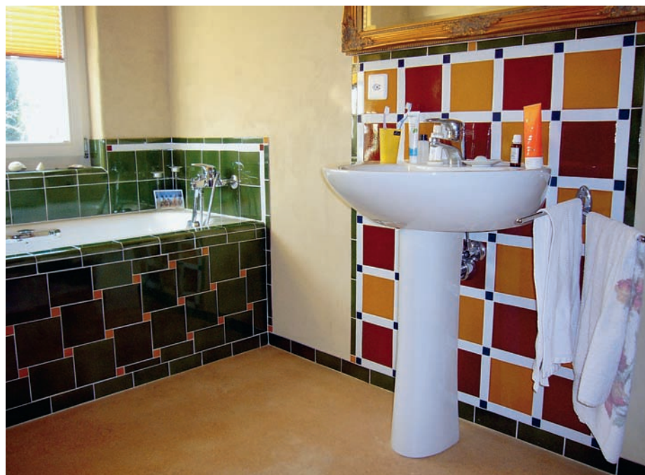
Lehm lässt sich auch in Feuchträumen applizieren. Spritzwasserbereiche müssen aber geschützt werden, z. B. wie hier mit Wandfliesen.
