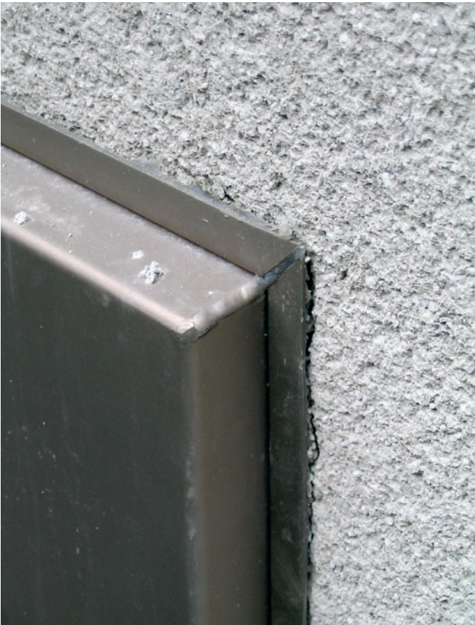
Bei diesem vorstehenden Fenster ist die Konstruktion mit Metallprofilen und Dichtstoff misslungen: Die WDVS-Deckschicht ist gebrochen.
