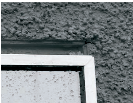
Bei diesem vorstehenden Fenster wurden nicht geeignete Profile ohne Detailplanung nicht fachgerecht eingebaut.
