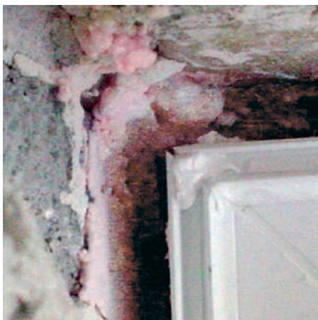
Bildausschnitt aus einem Prüfzeugnis. Im Eckbereich wurden die Profilstöße einfach mit Dichtstoff zugekleckert.
