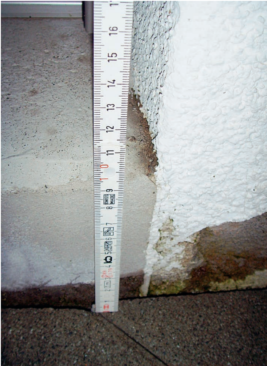
3 Kein Rost im feuchtebelasteten Sockelbereich – der Grund für die Rostausblühungen kann nicht in Feuchtigkeit alleine liegen.
