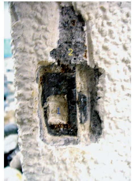
4 Eine Sondieröffnung zeigt eine der Ursachen für den Rost: den Klebemörtel.
