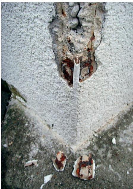
5 Auch bei dieser Sondieröffnung ist die rostfördernde Wirkung des Klebemörtels zu erkennen.
