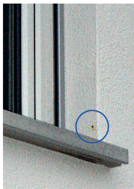
2 Rostflecken auch an einer gut vor Regen geschützten Fensterlaibung.
