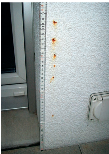
1 Rostausblühungen bei einem Kantenschutzprofil in einem Neubau.
