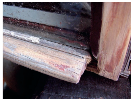
Verwittert: Stark lädierte Fensterschenkel mussten ausgetauscht werden.
