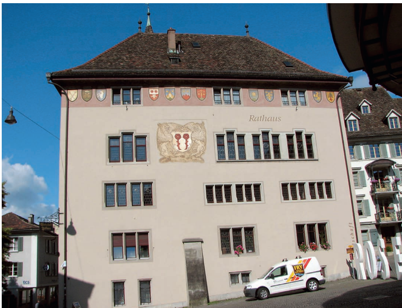
Imposant: Das Rathaus von Rapperswil-Jona mit seinen unzähligen Fenstern, welche restauriert werden mussten.
