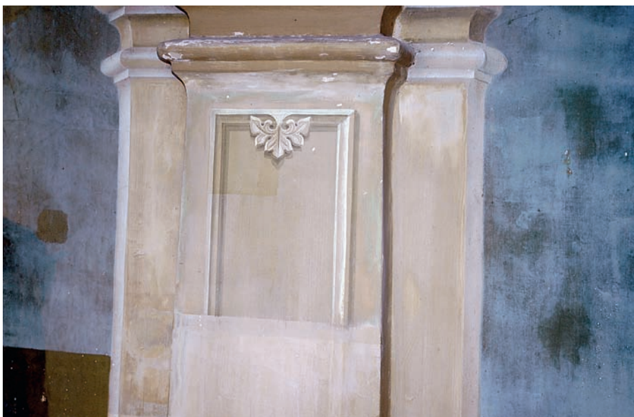
Die schrittweise Freilegung der Architekturfassung von 1852 in der Eingangshalle. (Foto: Castor Huser)
