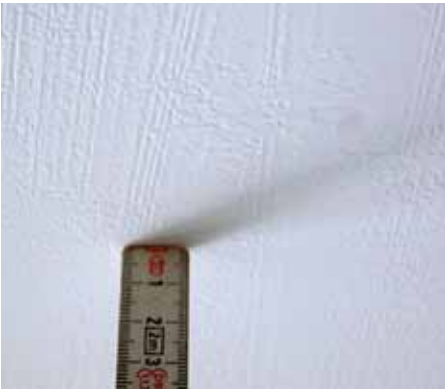
4 Diese starken streifenartigen Aufwölbungen der Beschichtung ergaben sich wegen einer Nachbearbeitung der Putzoberfläche vor dem Auftrag der Beschichtung.
