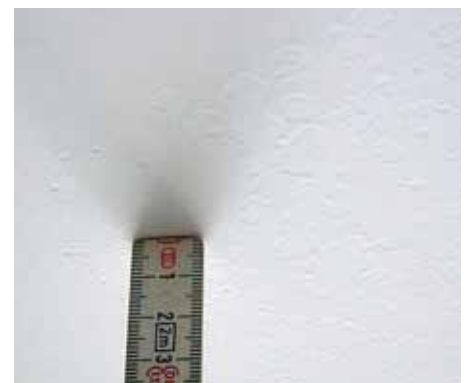
6 Als Folge von Kondensat im bereits applizierten Gipsputz können runde Aufwölbungen entstehen.
