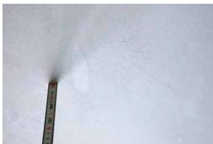
10 ... oder ein heller Fleck (z.B. von einer lokal aufgetragenen Isolierbeschichtung gegen Rostflecke) muss von einem geeigneten Beschichtungssystem überdeckt werden.
