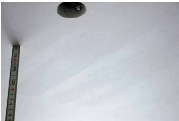
7 Striemenbildung aufgrund einer nicht ausreichend auf das Saugverhalten des Putzes abgestimmten Beschichtung.
