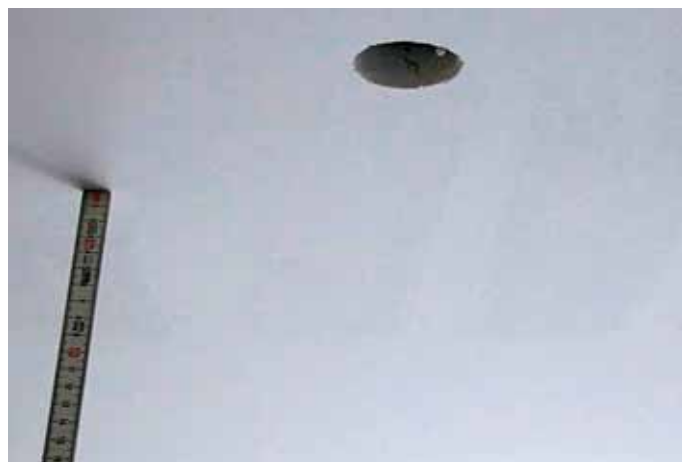
8 Wolken- und Striemenbildung aufgrund der Verwendung einer zu stark verdünnten gespritzten Beschichtung.
