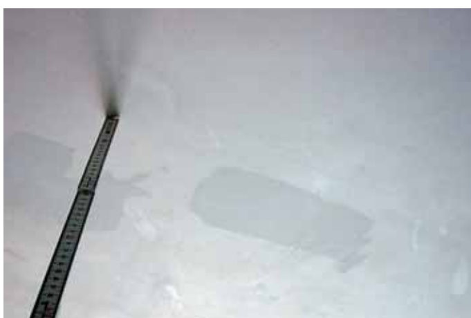
9 Ein solcher dunkler Fleck über einer Spachtelung ...
