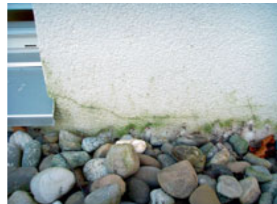
3 Durch Spritzwasser belasteter Bereich: der Bewuchs ist zu tolerieren.
