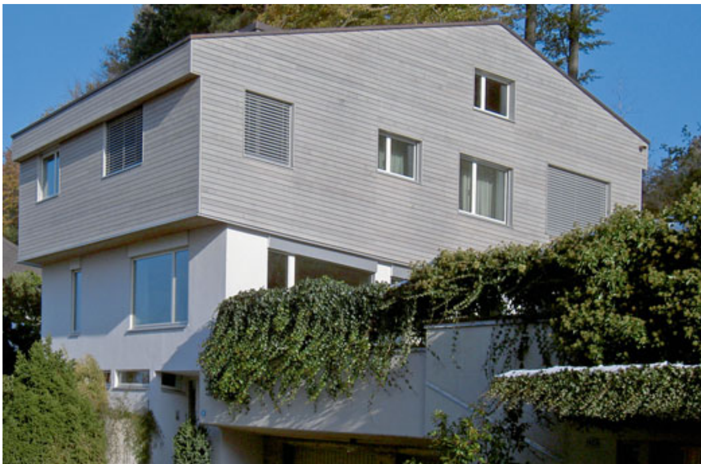
Silbergrau erscheint diese sägerohre Fassadenverkleidung in Uitikon-Waldegg (ZH) dank Behandlung mit einer Verwitterungslasur. (Bild: Kälin, Winterthur)
