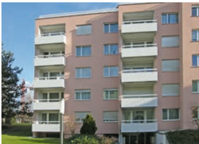
Mit Nanosilber-haltiger Farbe renovierte Hausfassade. An diesem Standort wurde der Fassadenabfluss auf \text{TiO}_2 -Weisspigmente und Nanosilber untersucht.
