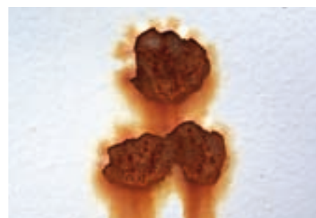
Abgeplatzt und dann gerostet: Die geeignete Grundierung hätte es verhindert.
