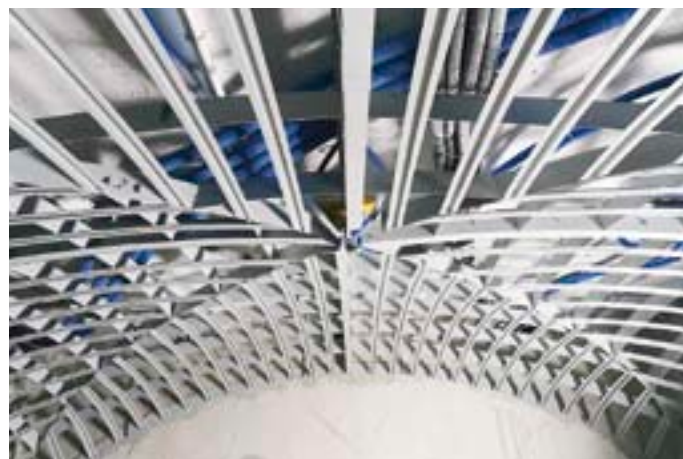
Schön versorgt: Die Haustechnik oberhalb der Unterkonstruktion.
