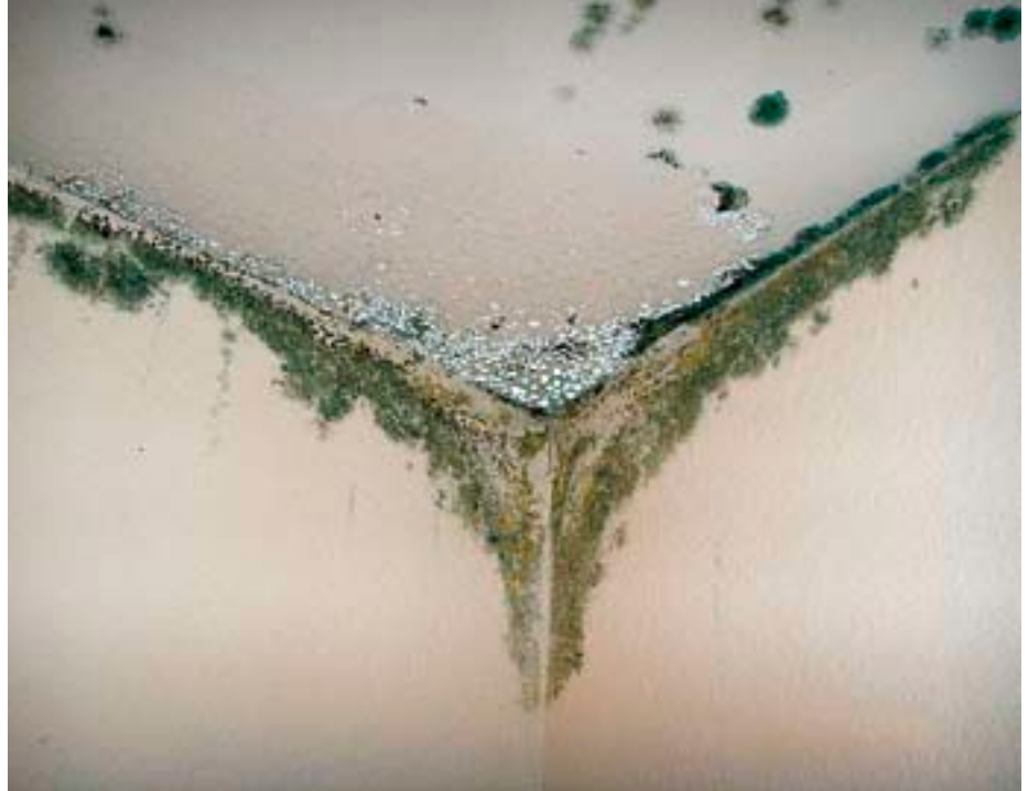
Um ein Schimmelpilzproblem dauerhaft in den Griff zu bekommen, müssen bauliche Mängel behoben werden.
