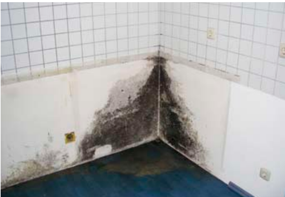
Entscheidend für die Auswahl des richtigen Sanierungsverfahrens sind die Art des Befalls und die Untergrundbeschaffenheit.
