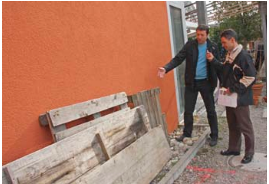
Auch davor warnt die Instandhaltungsanleitung: Das Anlehnen von Gegenständen an die Fassade kann zu Beschädigungen führen.
